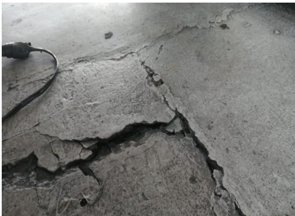
Imagen 3. Estado actual pista mixta.
