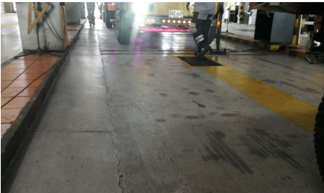
Imagen 2. Estado actual pista mixta.
